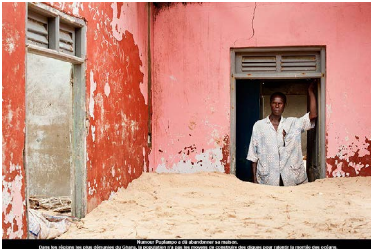
Namour Puplampo a dû abandonner sa maison. Dans les régions les plus démunies du Ghana, la population n'a pas les moyens de construire des digues pour ralentir la montée des océans.
